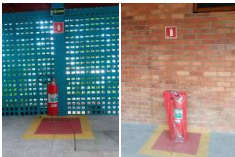
Figura 7: Pontos com extintores
